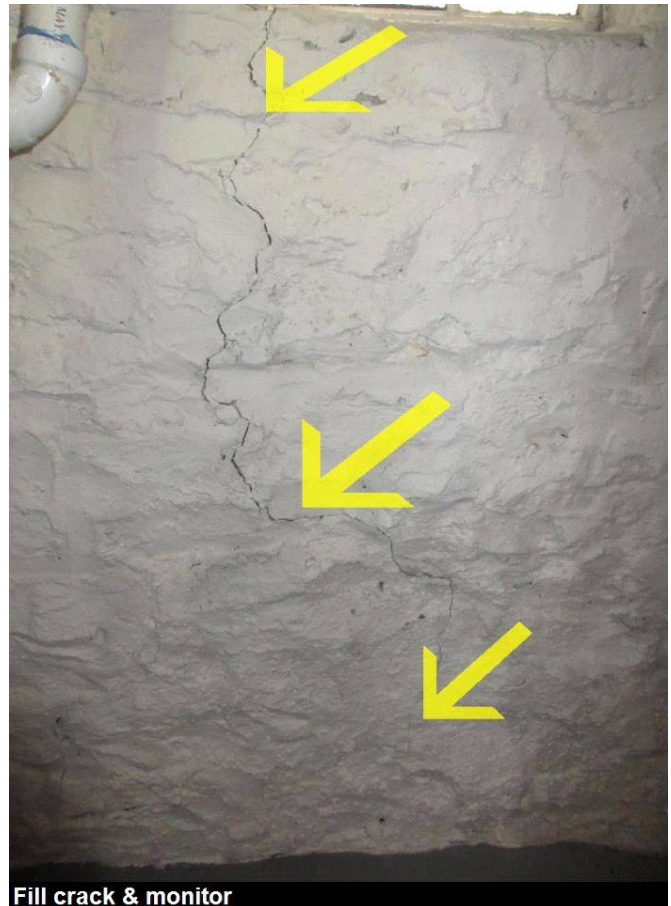
Fill crack & monitor
